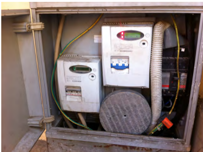
Figura 2 - Contatori energia elettrica presso Piazza Fanti
